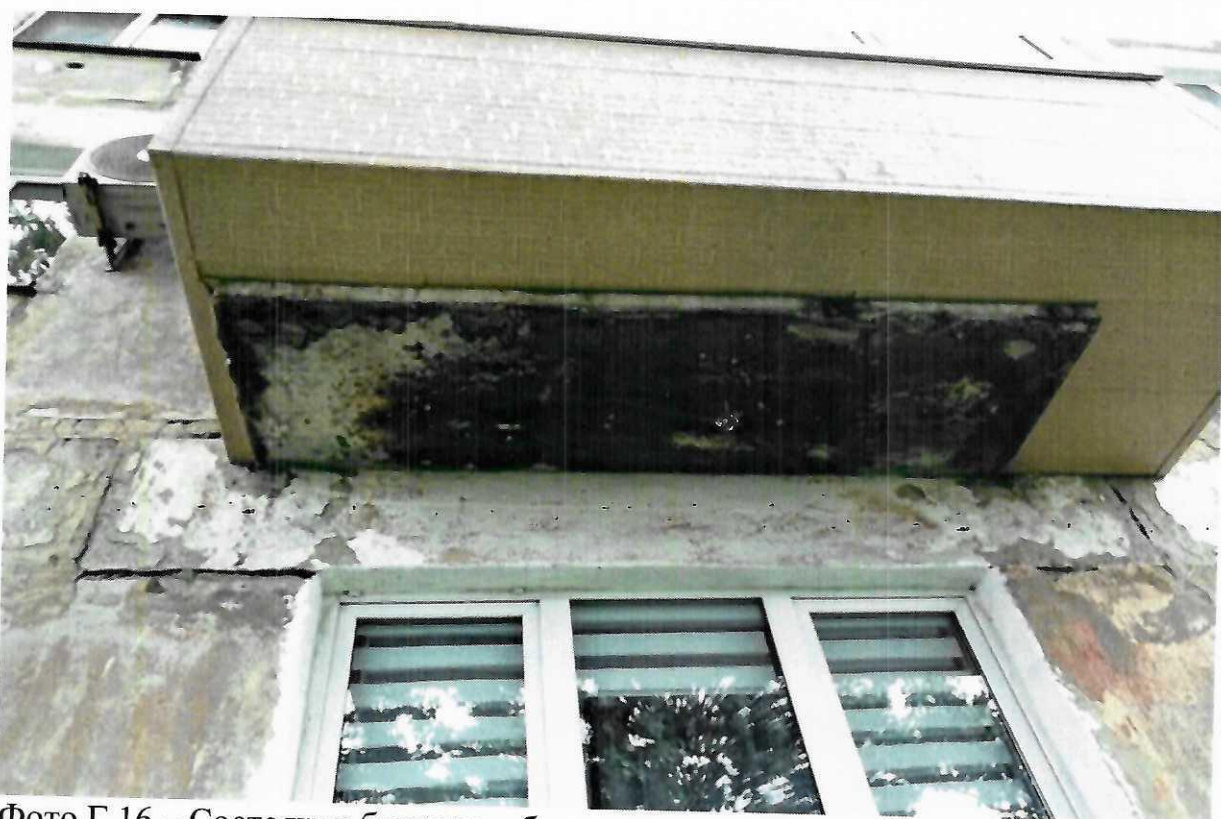
Фото Г.15 – Состояние балконов: балконные плиты повреждены (разрушение защитного слоя бетона); следы затекания на поверхности бетона плиты.
