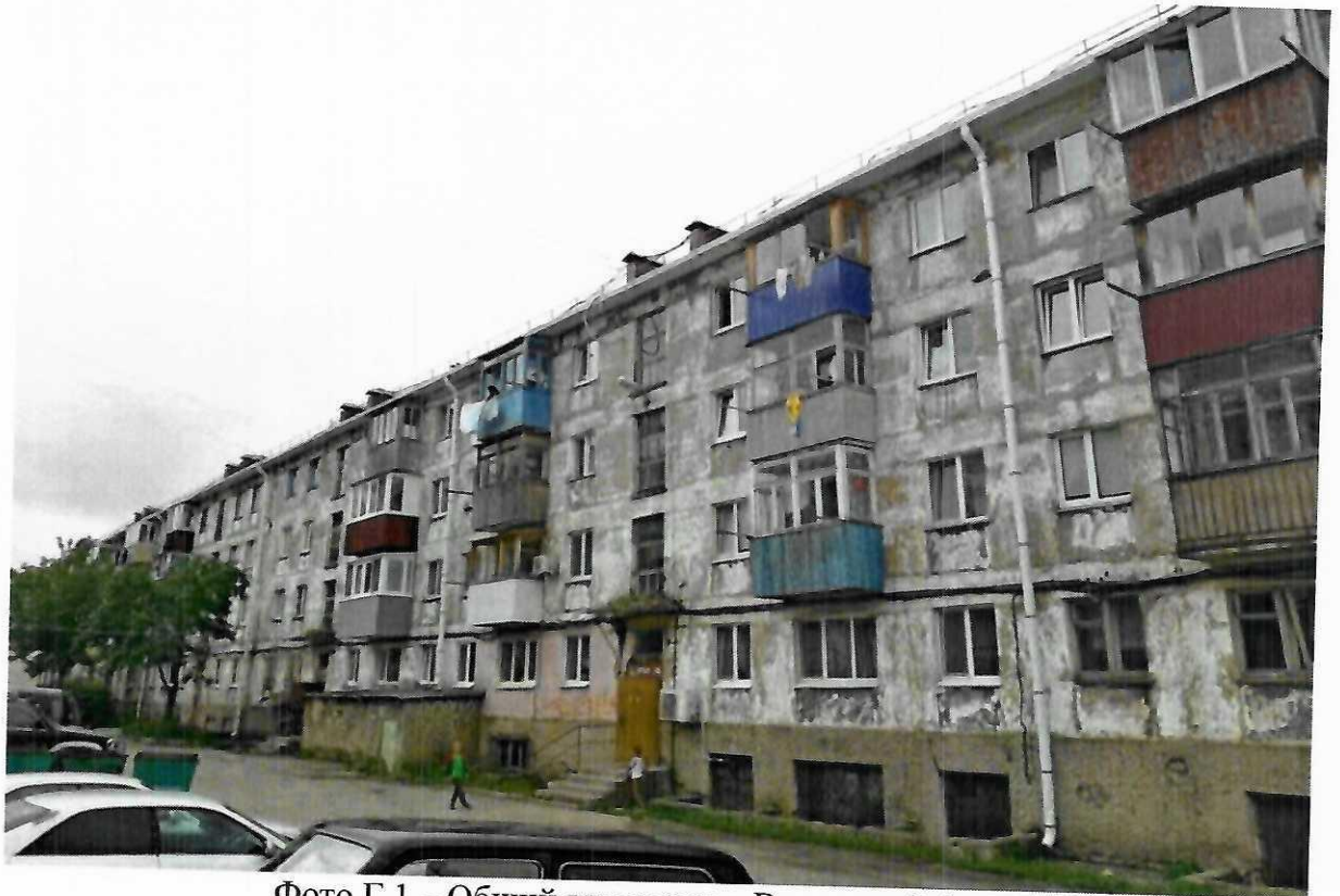
Фото Г.1 – Общий вид здания. Восточный фасад. Повреждения штукатурного слоя цоколя. Отслоение защитного слоя блоков. Следы ремонта межблочных швов.
