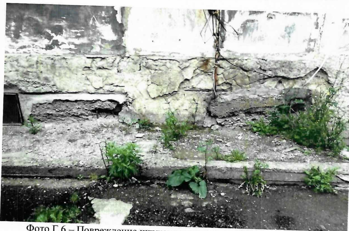
Фото Г.5 – Повреждение штукатурного слоя цоколя, выраженные отслоением, трещинами, следы биоповреждений и увлажнения стен. Взамен отмостки выполнено асфальтовое покрытие, наличие растительности.
