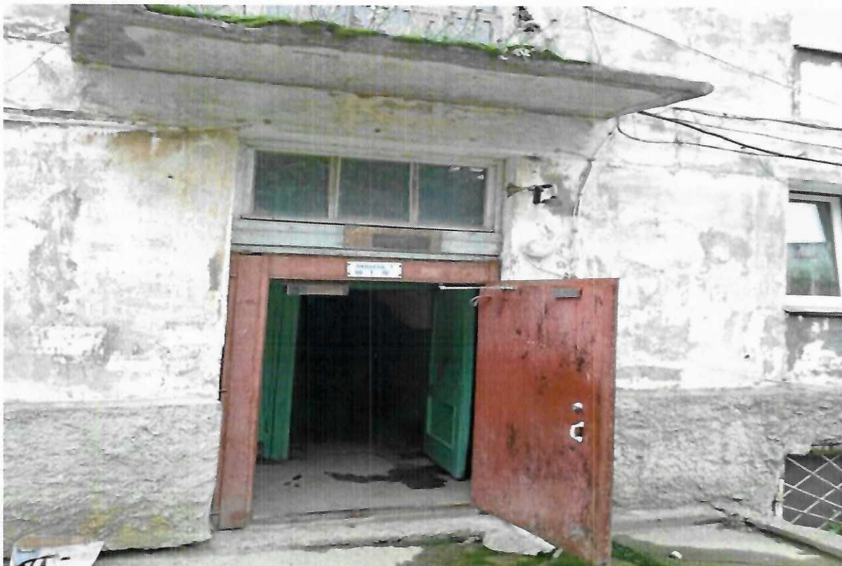
Фото Г.11 – Повреждение плиты козырька: следы увлажнения и промерзания на нижней части плиты, гидроизоляция повреждена, наличие растительности. Двери входа в подъезд металлические, полотна осели или имеют плохой притвор по периметру коробки, отслоение лакокрасочного слоя следы коррозии.
