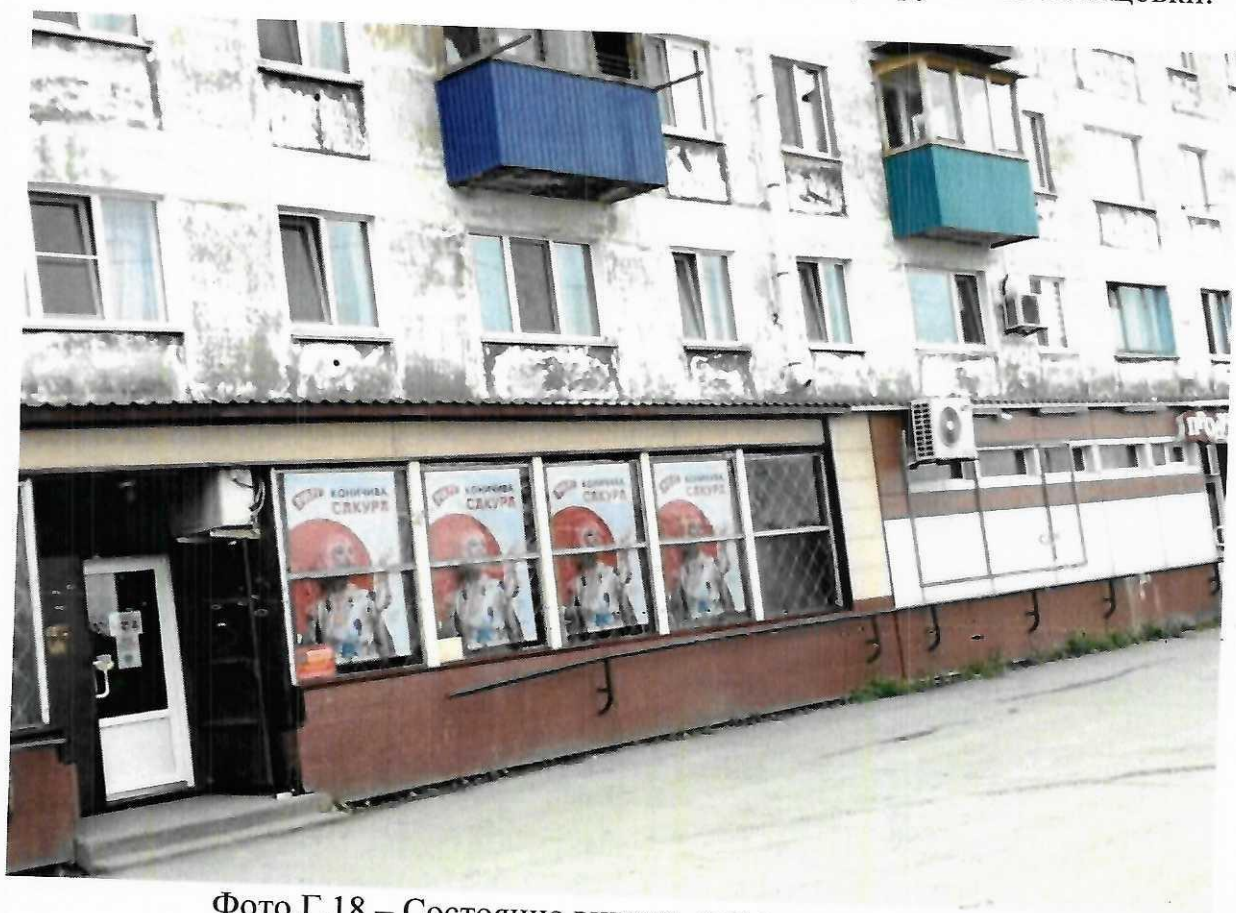
Фото Г.17 – Состояние витрин, козырька магазина: разрушение облицовки.
